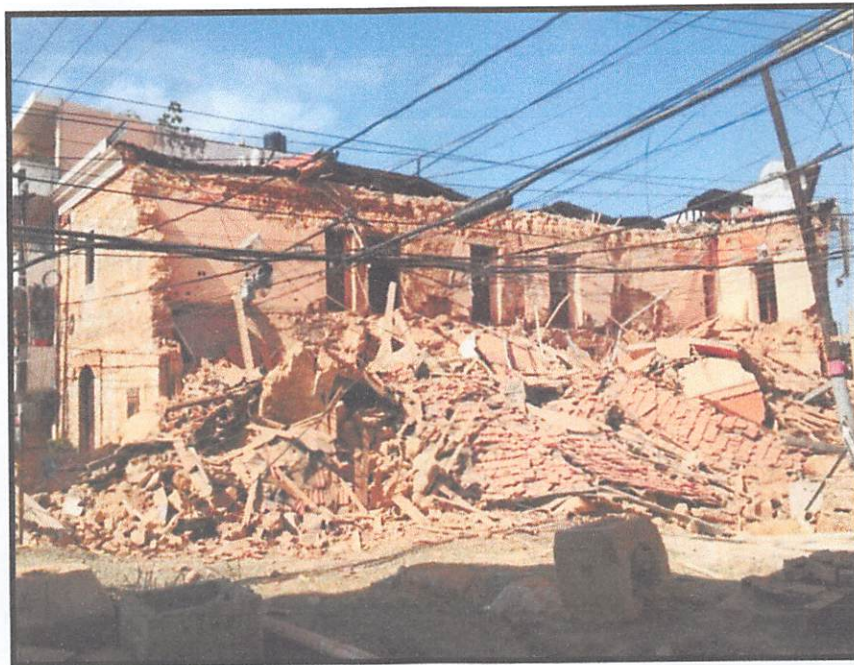
Ilustración 1. Derrumbe parte frontal Hotel Francés en mayo del 2015
